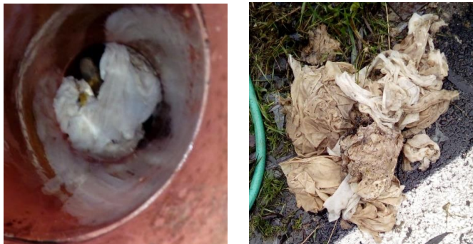
Foto ucpaného odpadu – kanalizace ve Stárkově
